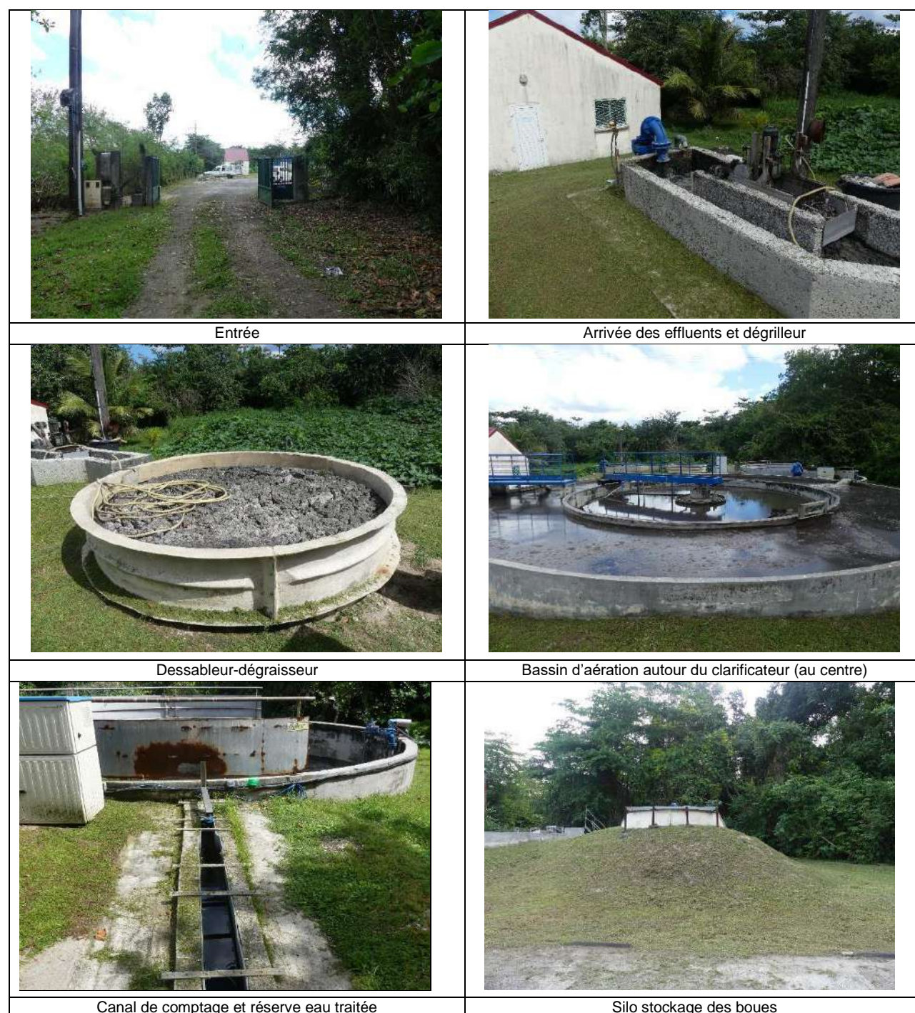
Figure 4 – Clichés photographiques des ouvrages de la station d'épuration actuelle de Folle Anse
